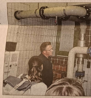
Wassermeister Mirco Schley erklärte den Hochbehälter.
